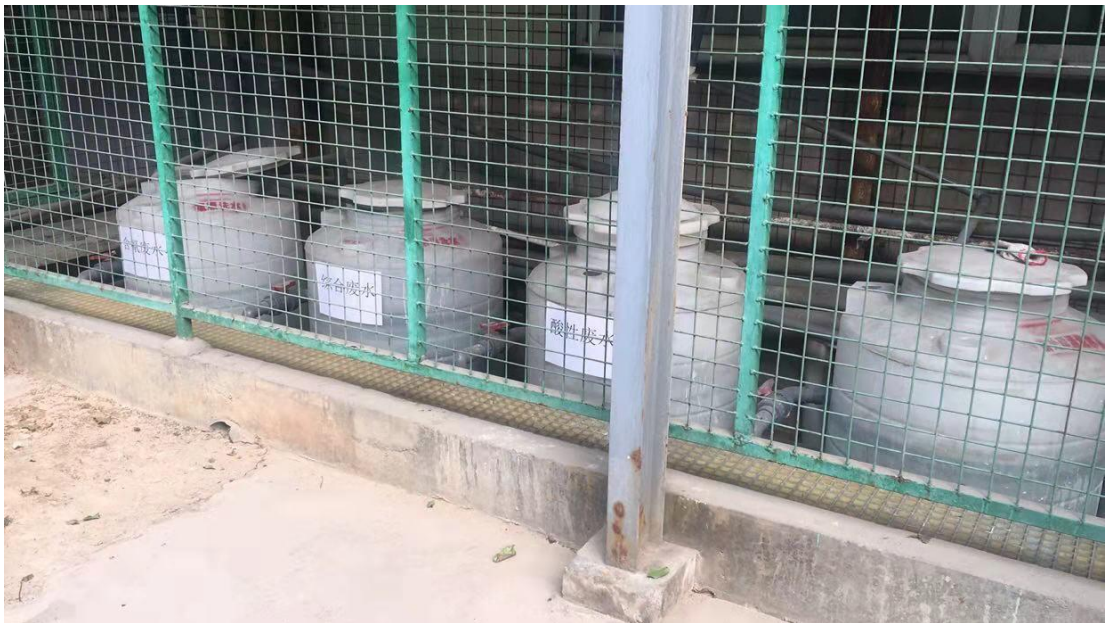
图 7.1-2 废水分类收集罐照片
