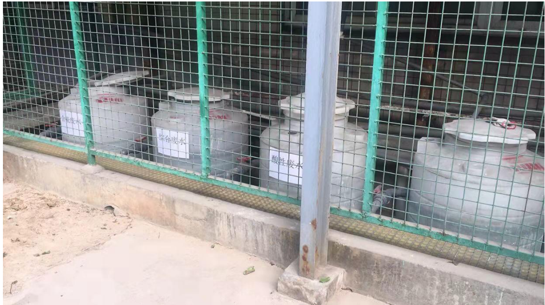
图 7.1-2 废水分类收集罐照片
